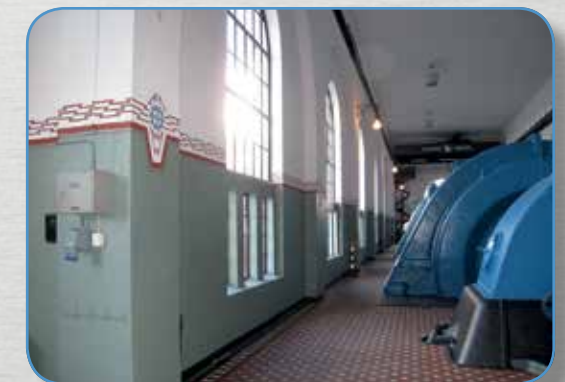
Kraftwerk Tyssedal (N)
